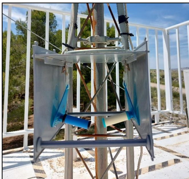
Fotografía 1. Instalación de Pasivos Radiello
